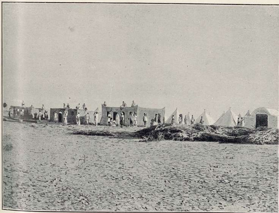
CONSTRUCTION DU BORDJ D'EL GOLEA PAR LES TIRAILLEURS DU 1 er RÉGIMENT. D'après une photographie du commandant Lamy.
